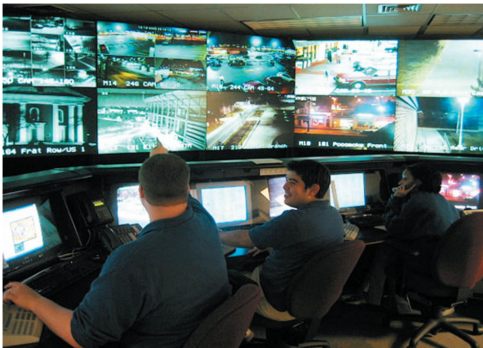
Bei der Videofernüberwachung bescheiden sich die Notruf-Service-Leitstellen meist noch mit Bildern niedriger Auflösung. Megapixel-Lösungen im Objekt spielen noch keine Rolle. Ein wichtiger Grund: In den Leitstellen würde neues Equipment notwendig. Bild: UMD Eskin
