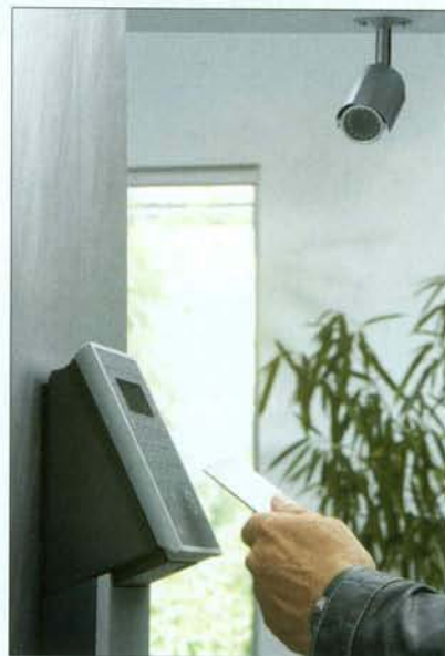
Durch die Videoüberwachung der Zutrittsbuchung können Bedrohungen frühzeitig erkannt und Gegenmaßnahmen ergriffen werden
